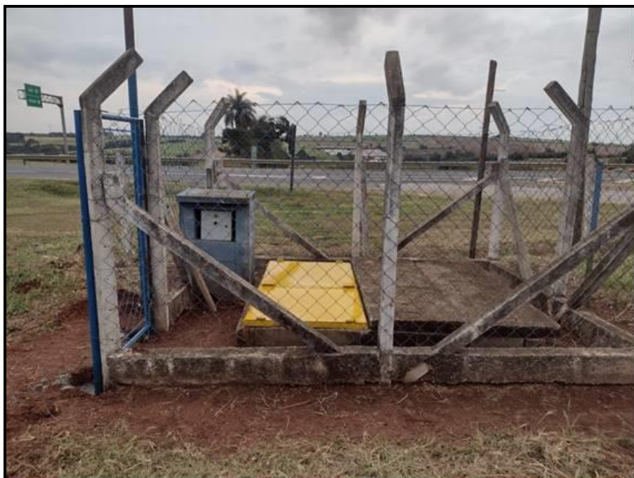
Figura 74 - Estação elevatória de esgotos Novo Tempo – São Miguel
