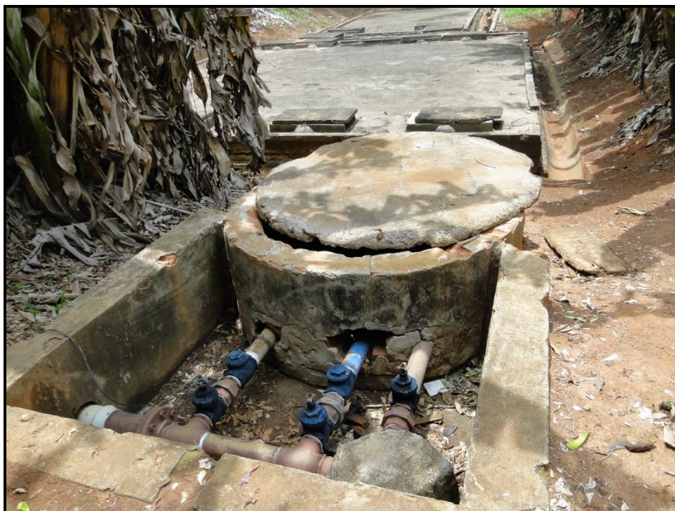
Figura 66 - Estação elevatória de esgotos São Marino
