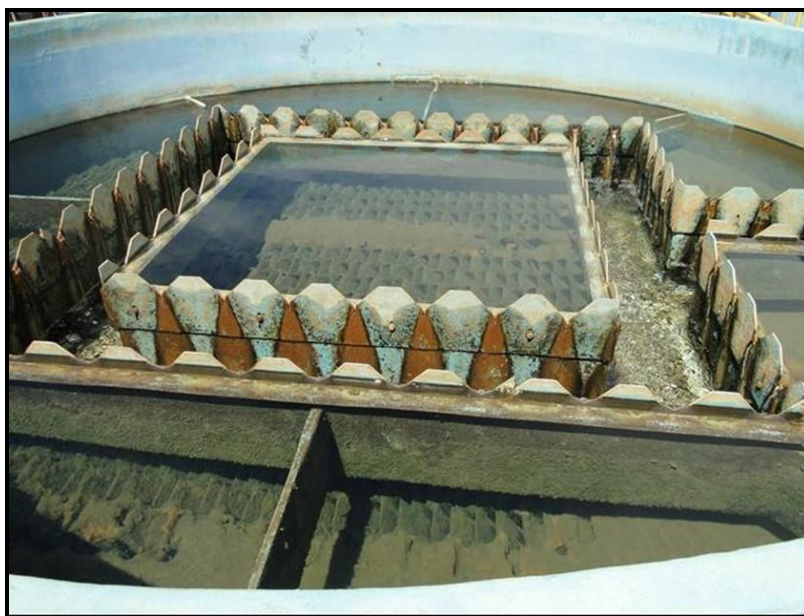
Figura 37 - Decantador da ampliação da ETA III
