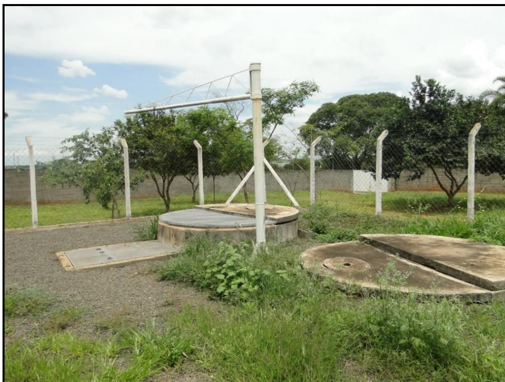
Figura 67 - Estação elevatória de esgotos São Luiz
