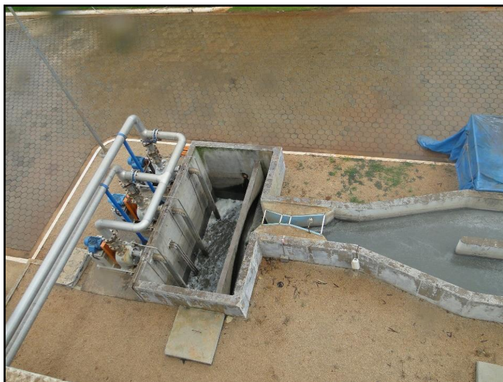
Figura 86 - Caixa de areia, calha Parshall e estação elevatória
