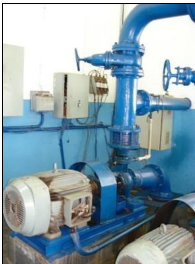
Figura 50 - Estação elevatória 1 – ETA II
