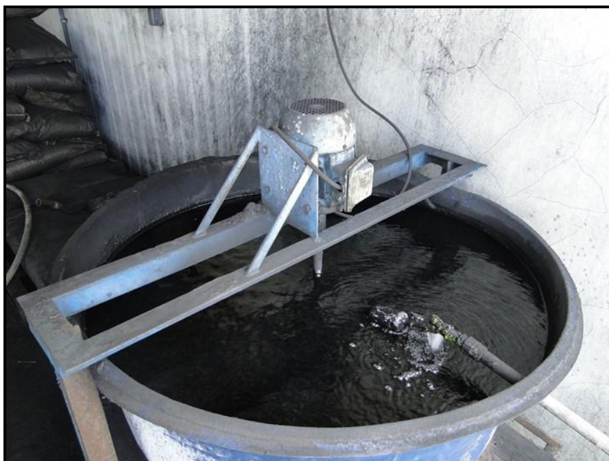
Figura 44 - Sistema de armazenamento de carvão ativado pulverizado
