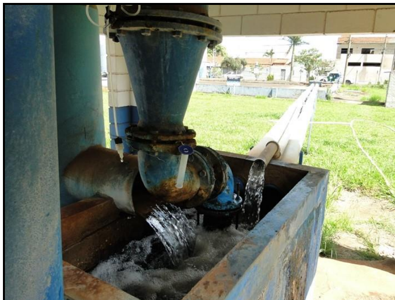
Figura 39 - Caixa de distribuição da água produzida na ETA III
