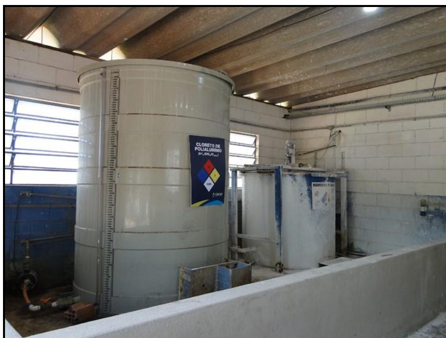
Figura 42 - Sistema de armazenamento de produtos químicos Cloreto de Polialumínio
