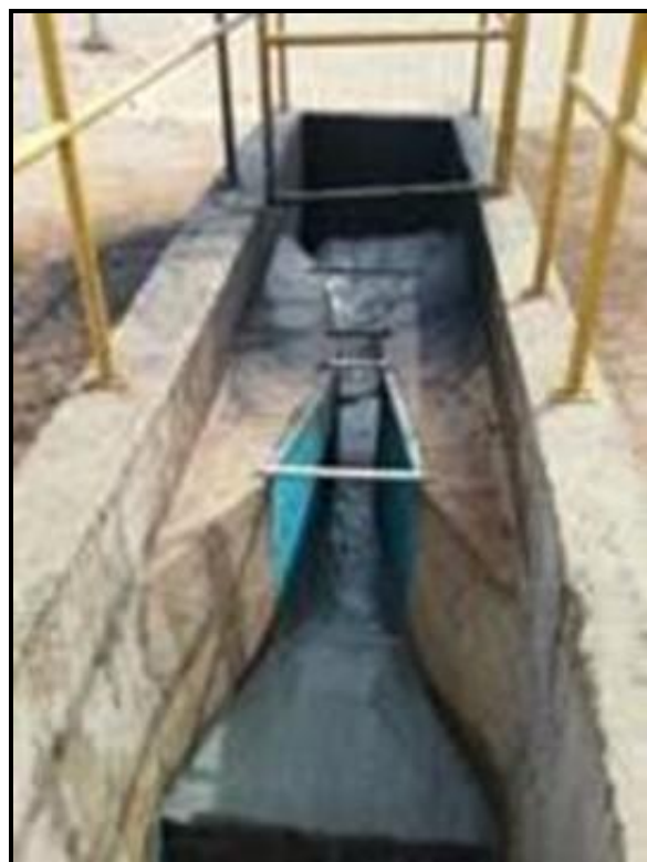
Figura 83 - Medidor de vazão de saída – Calha Parshall
