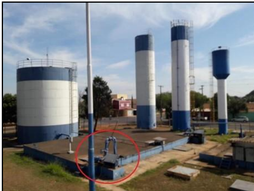
Figura 57 - EEA e Reservatórios da ETA III
