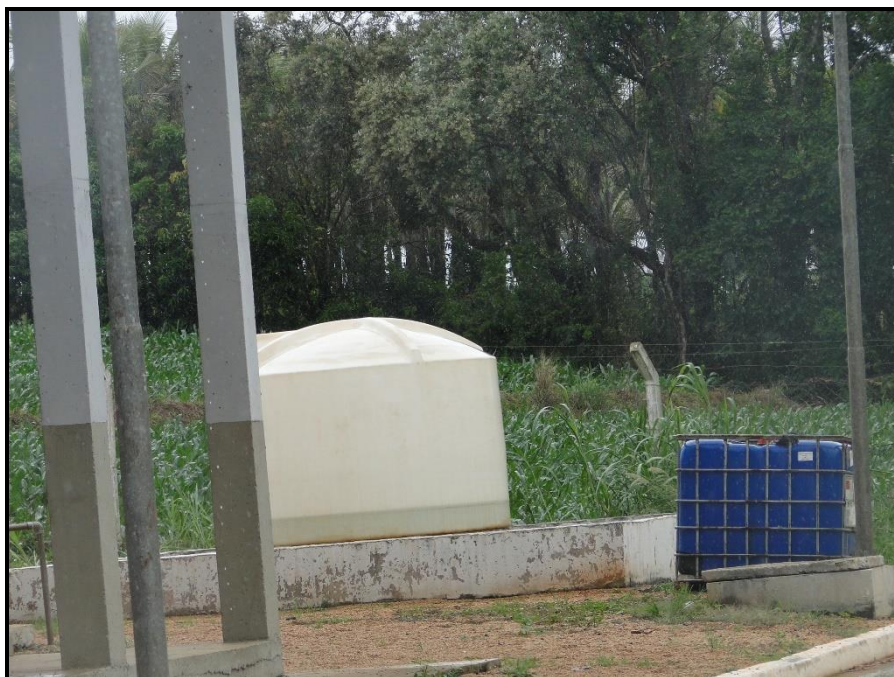
Figura 95 - Tanque de armazenamento de hipoclorito de sódio
