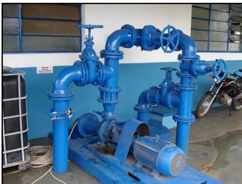
Figura 53 - Estação elevatória 2 – ETA II
