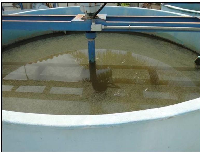
Figura 36 - Floculador da ampliação da ETA III
