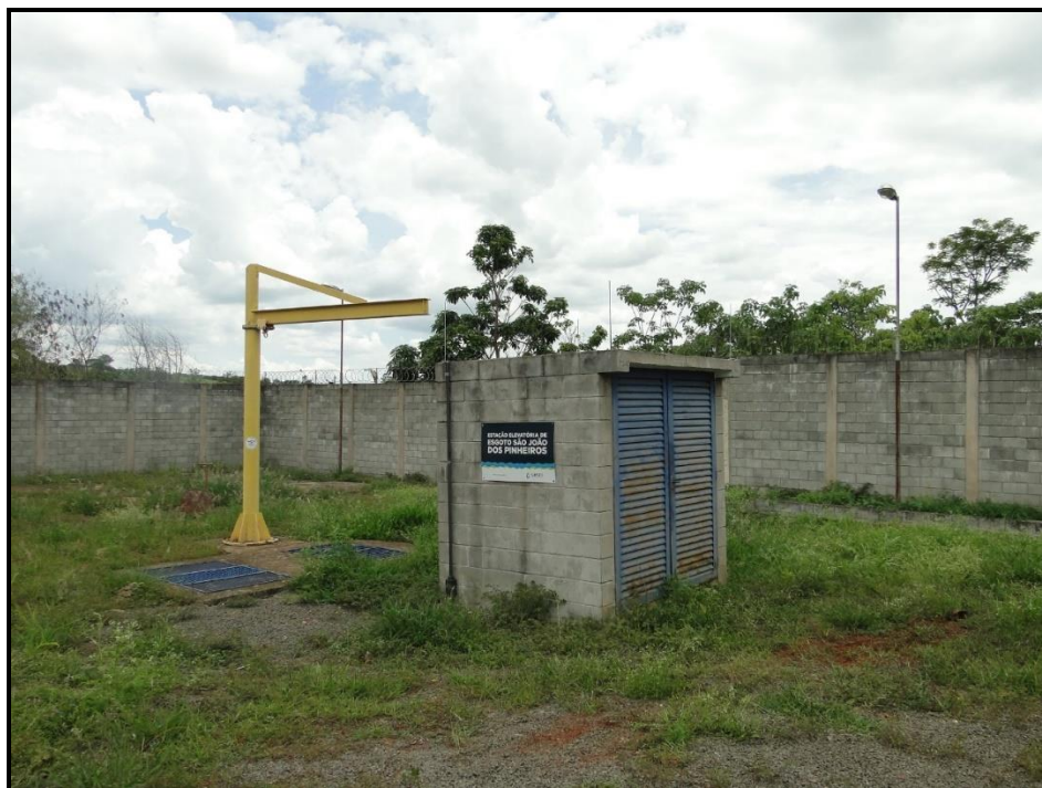
Figura 68 - Estação elevatória de esgotos São João dos Pinheiros
