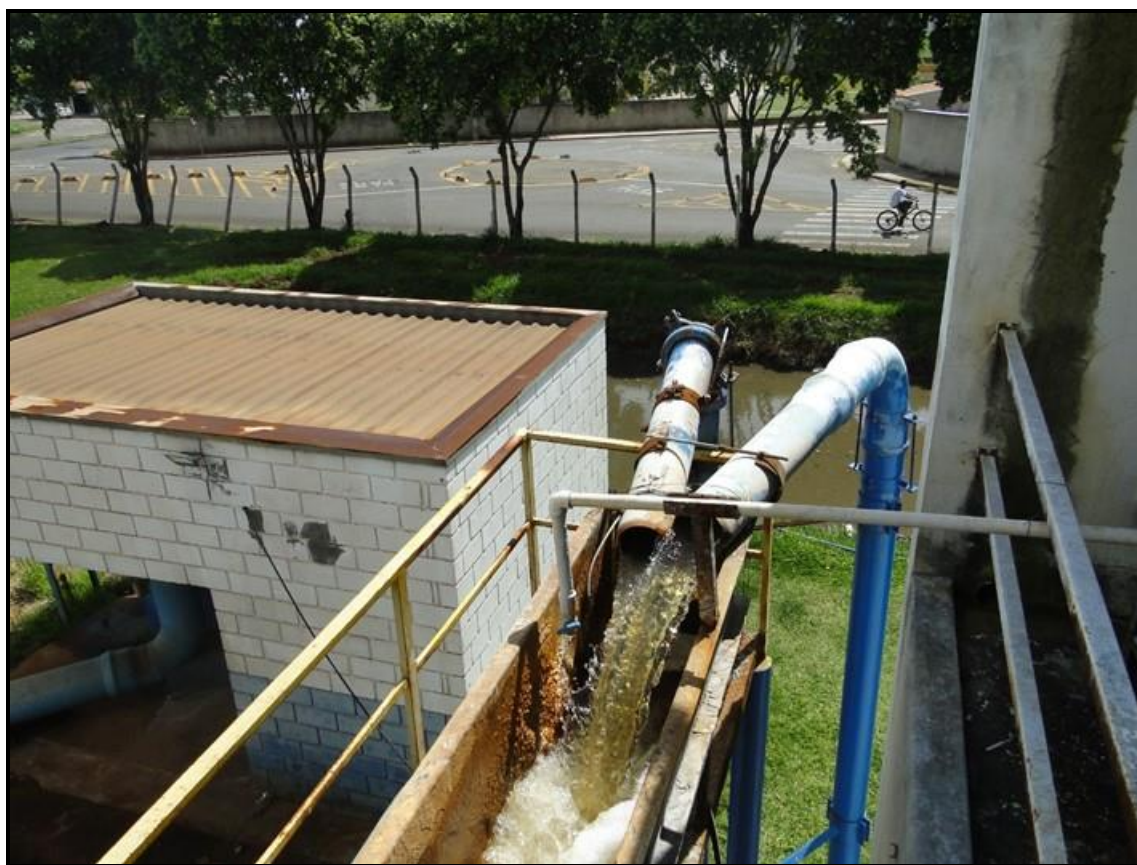
Figura 34 - Caixa de chegada da água proveniente das captações Prainha e Poquinha
