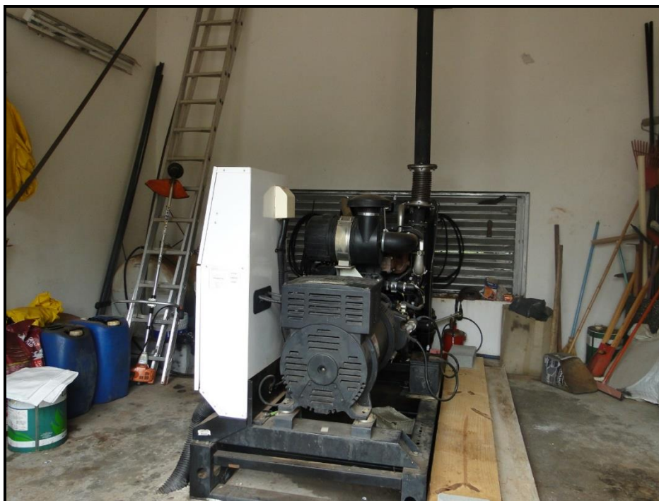
Figura 96 - Gerador de energia elétrica
