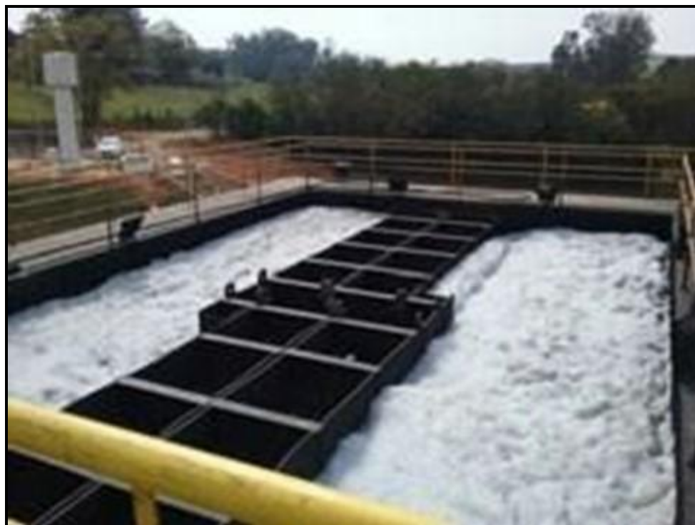
Figura 81 - Reator aeróbico e decantador
