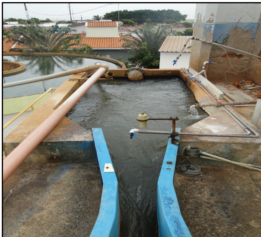
Figura 25 - Mistura Rápida - Calha Parshall na chegada da ETA II
