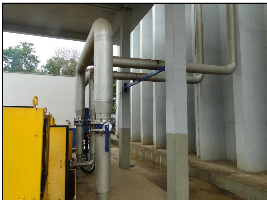
Figura 92 - Tubulação para injeção de ar nos reatores
