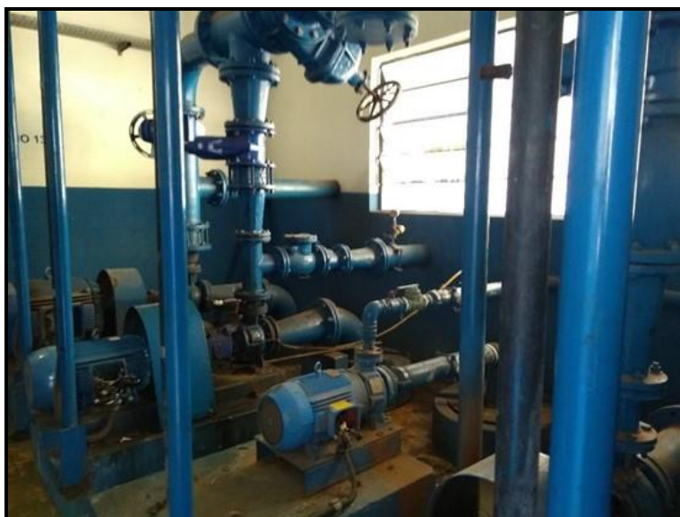
Figura 49 - Estação elevatória 1 – ETA II
