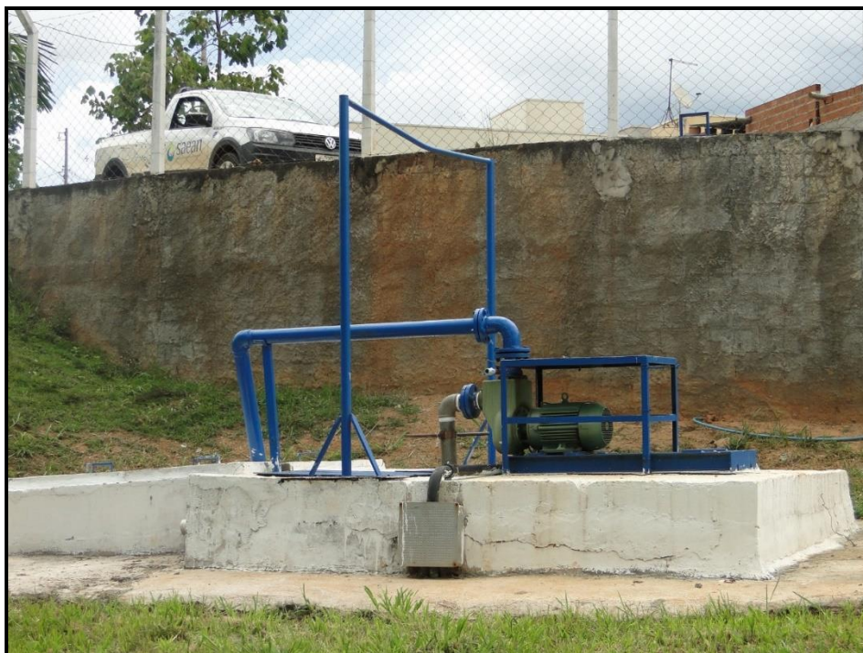
Figura 72 - Estação elevatória de esgotos Residencial da Torre
