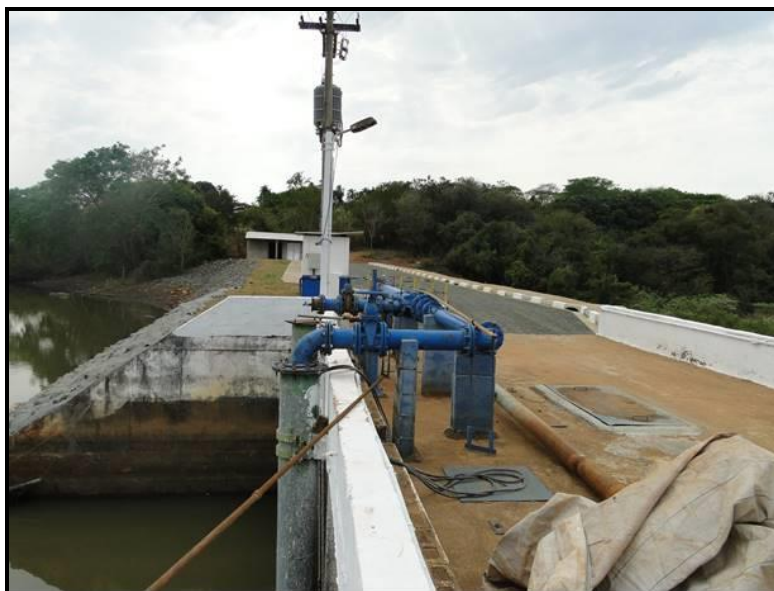
Figura 15 - Sistema de captação da represa
