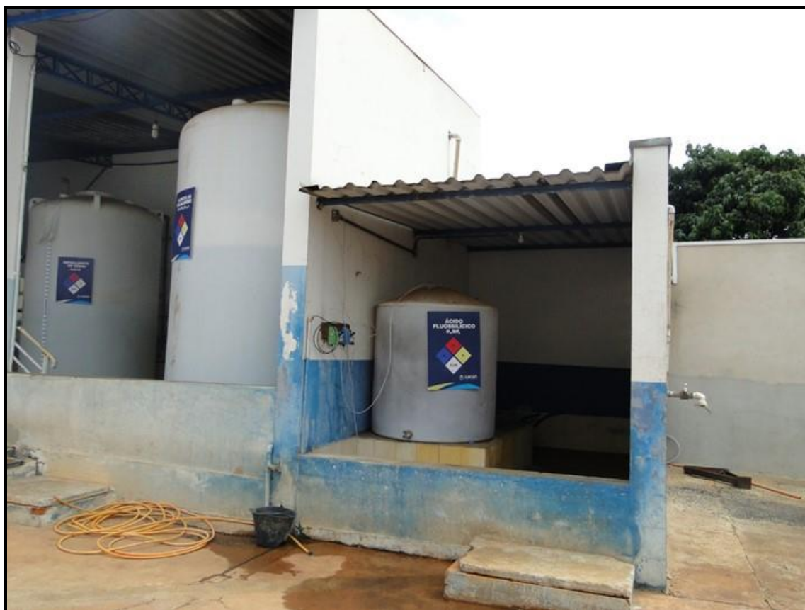
Figura 30 - Sistema armazenamento de produtos químicos
