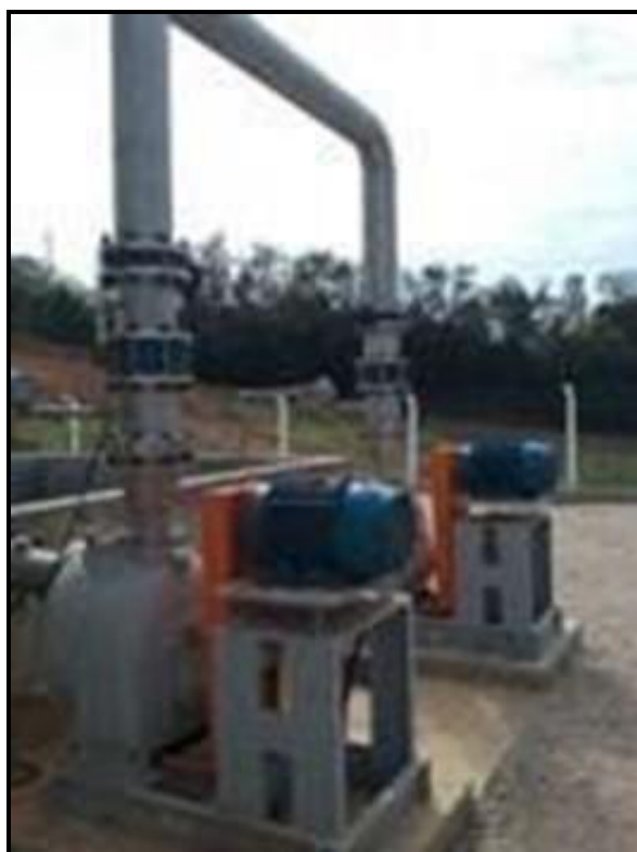
Figura 79 - Bombas de recalque do esgoto para o UASB
