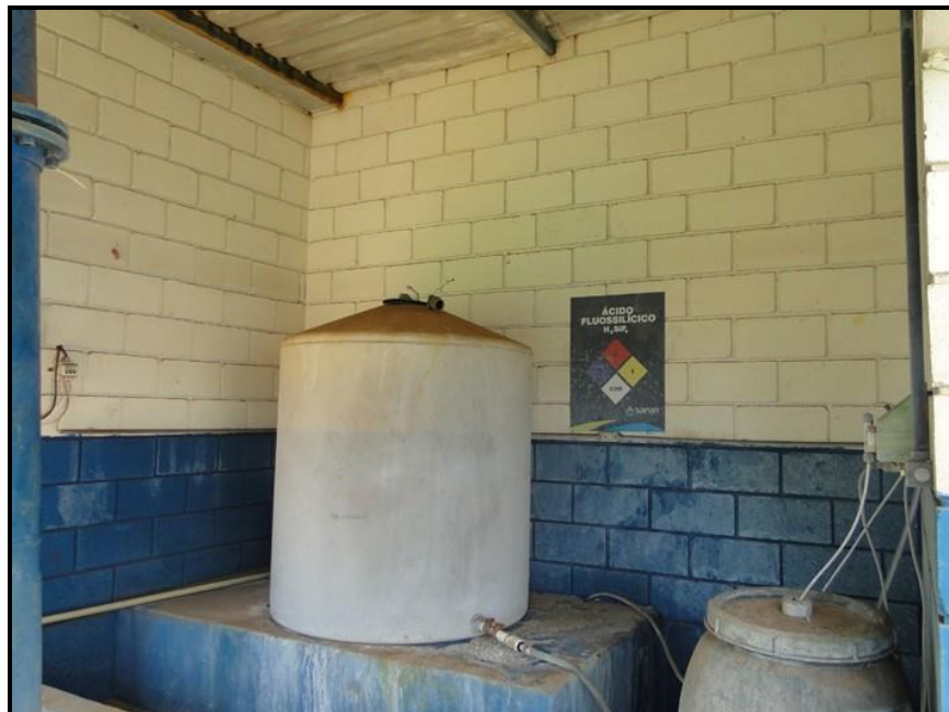
Figura 43 - Sistema de armazenamento de produtos químicos Ácido Fluossilícico
