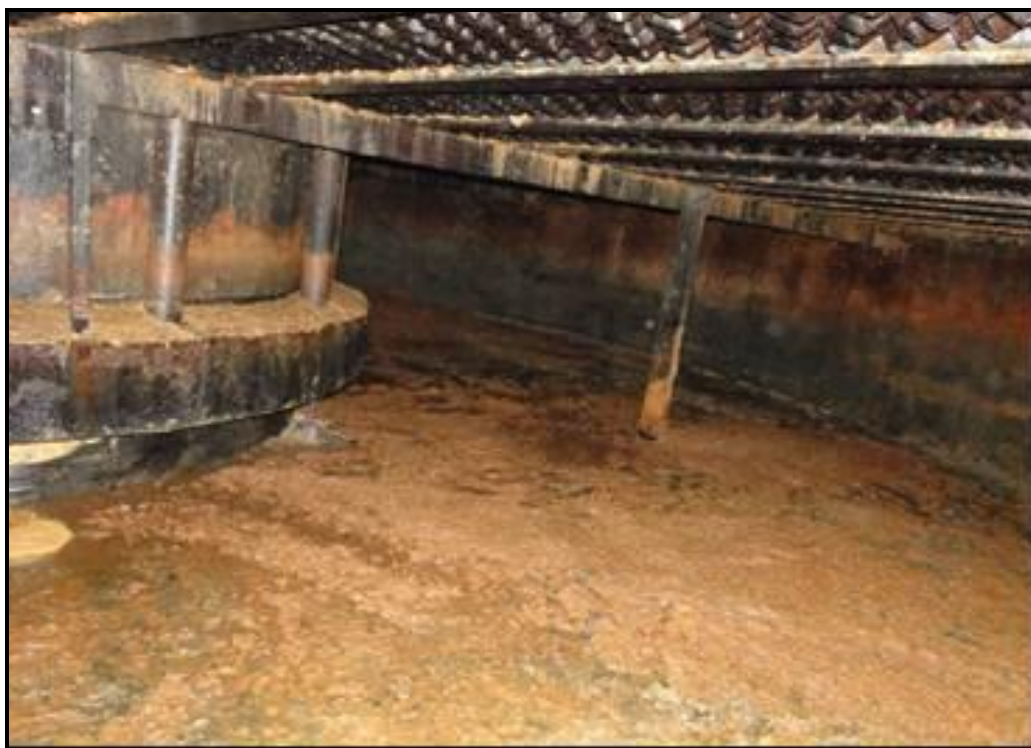
Figura 27 - Lavagem dos floculadores e decantadores
