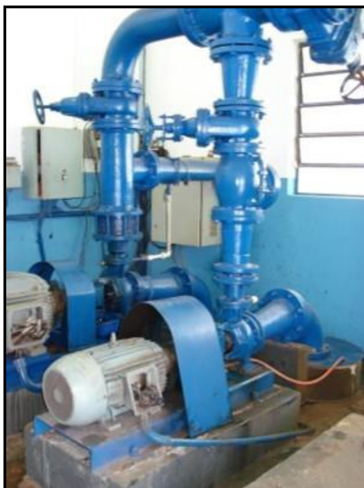
Figura 51 - Estação elevatória 1 – ETA II
