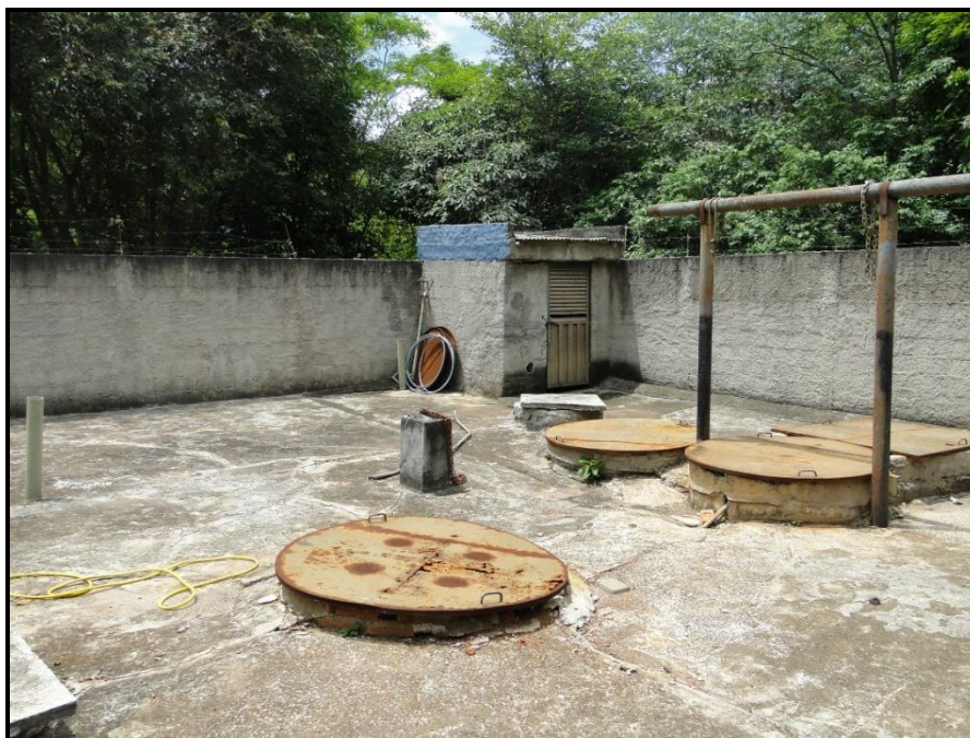
Figura 65 - Estação elevatória de esgotos Rota das Flores
