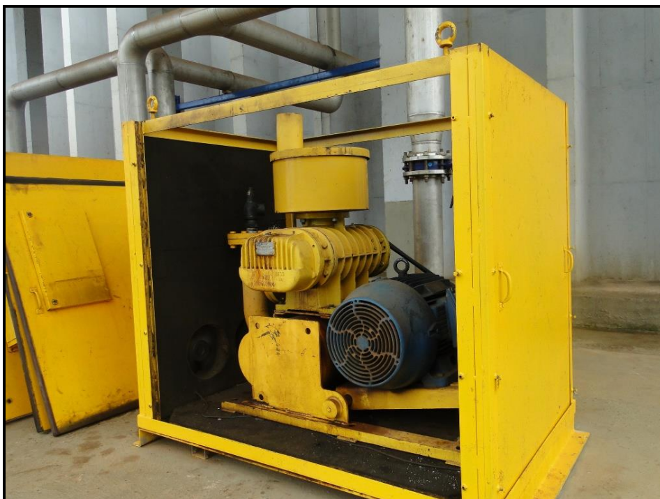
Figura 91 - Sopradores de ar
