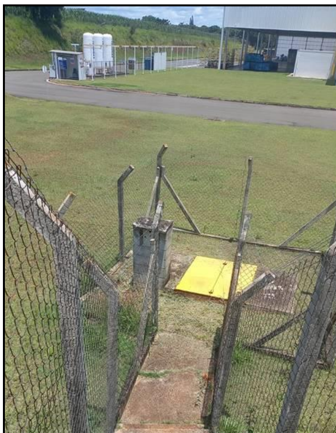
Figura 73 - Estação elevatória de esgotos Toyota
