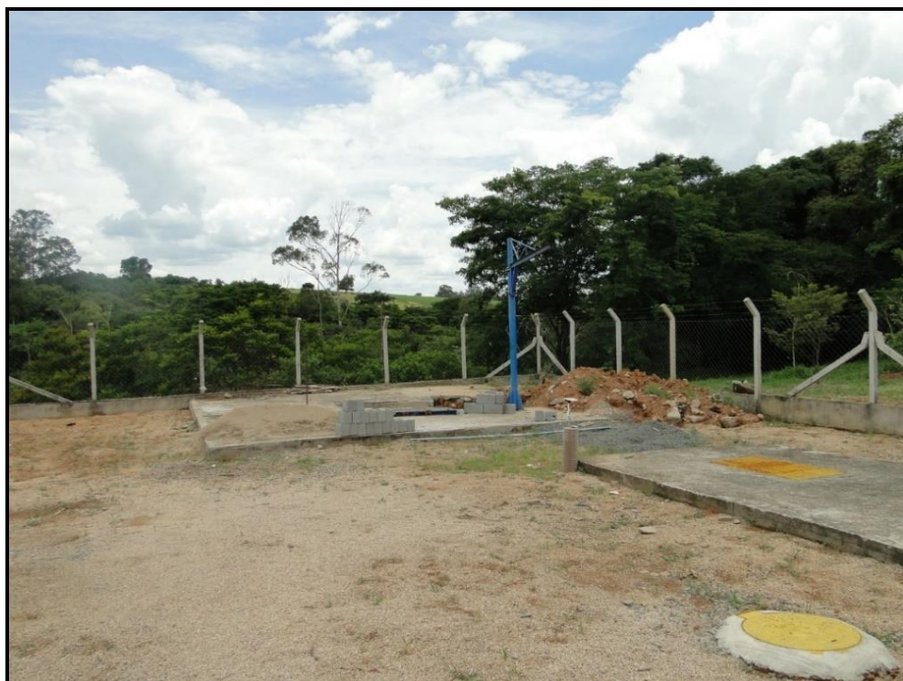
Figura 69 - Estação elevatória de esgotos Vila Nogueira
