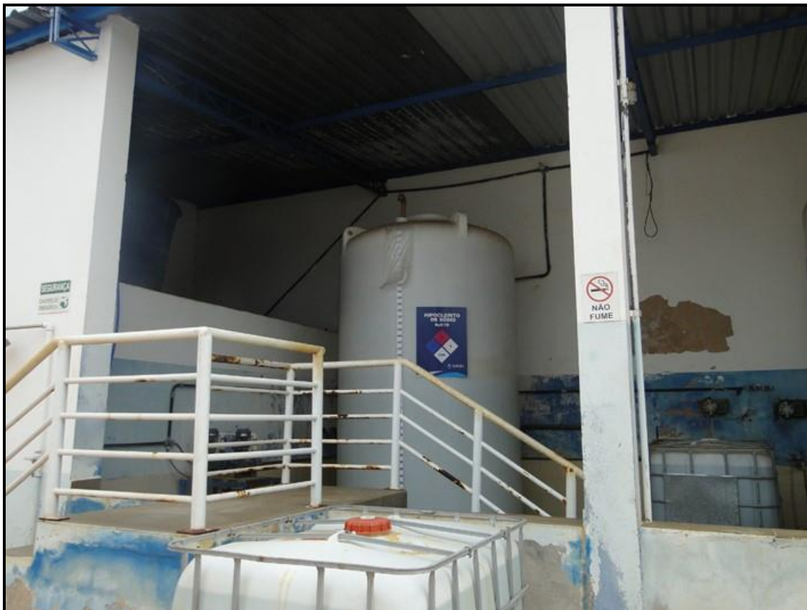
Figura 31 - Sistema armazenamento de produtos químicos
