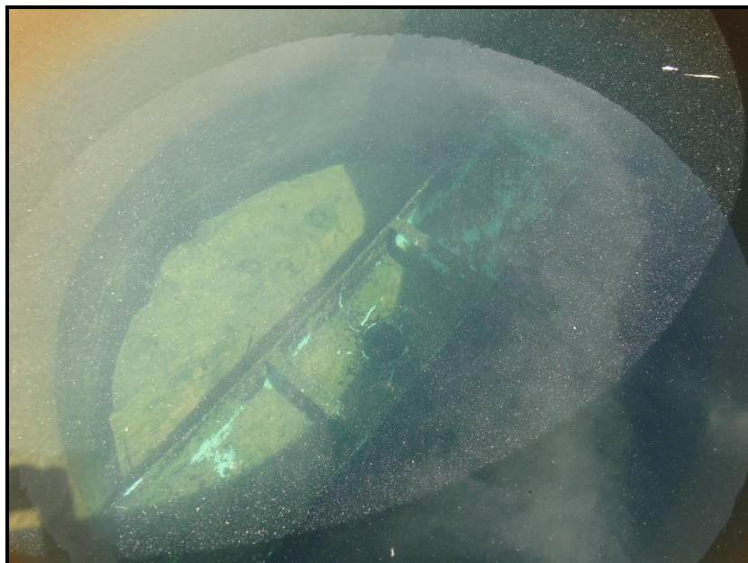
Figura 38 - Filtro da ampliação da ETA III
