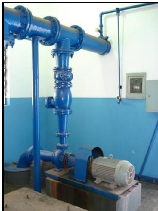
Figura 52 - Estação elevatória 1 – ETA II
